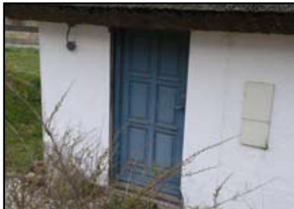
Ny fyldningsdør. Der er en pladebeklædning på dele af tilbygning.
